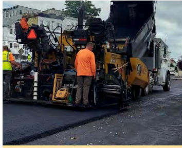
Lát lại các đoạn đường xe chạy bị hư hỏng
